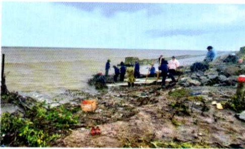
Khắc phục hậu quả đê biển Cà Mau do mưa bão gây ra
