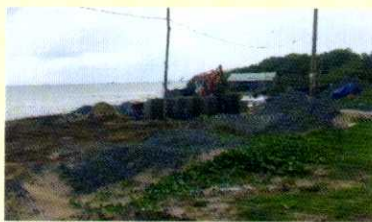
Khu vực sạt lở bờ biển tại xã Trường Long Hòa, thị xã Duyên Hải, tỉnh Trà Vinh
